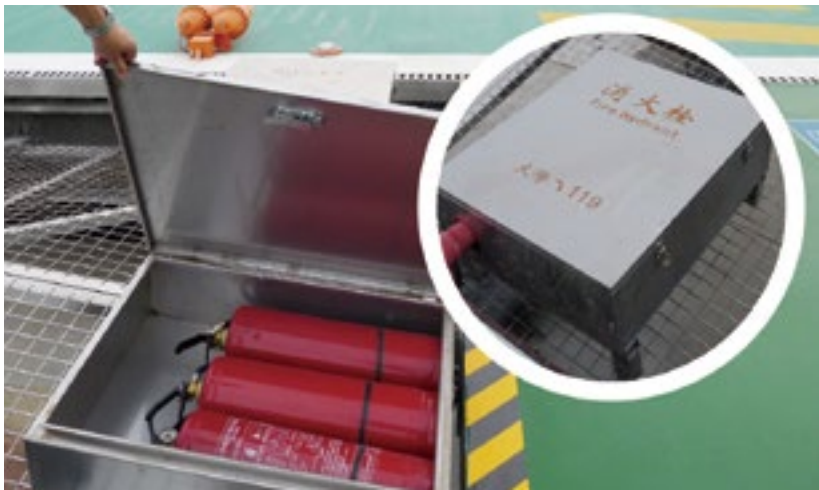
对比全铝多层直升机停机坪系统的自动消防设施，某省人民医院所建的停机坪依靠这种人工操作的消防装置反应时间及灭火效果可想而知
