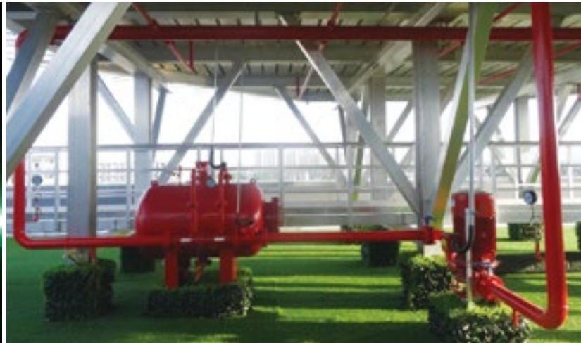
全铝多层直升机停机坪面板下红色管道及储藏罐是压力式泡沫灭火子系统，该系统视不同火情可以在瞬间喷射泡沫或水剂
